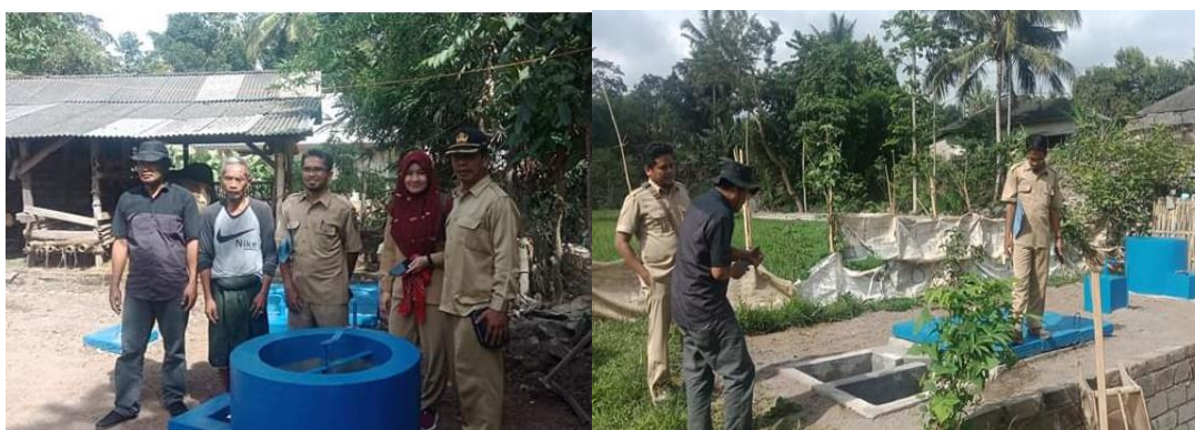
Gambar 6.1. Pembangunan Digester Biogas di Desa Pesangrahan Kecamatan Montong Gading Kabupaten Lombok Timur
